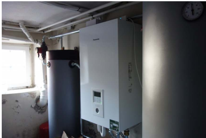
Luft til Vand
