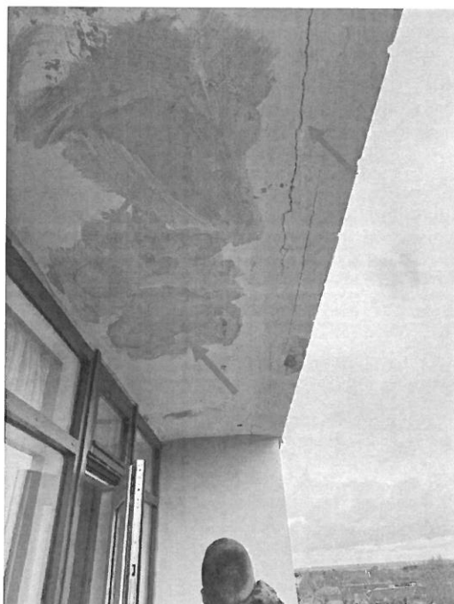
Foto 4: Mindre seværdig betonreparation af altanpladens underside. Revnedannelse mellem altandæk og betonbrystning
