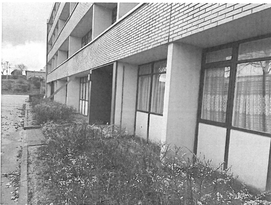
Foto 5: Altanbrystning med tydelig udbøjning.
