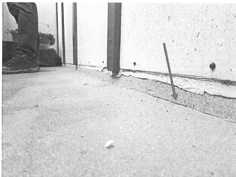
Foto 2: Altandækkets afslutning under snedkerpartier. Der er nærliggende risiko for vandet løber under den skrå påstøbning-
